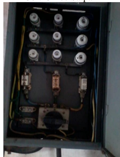
Gbr.16 Kondisi PHB Listrik
