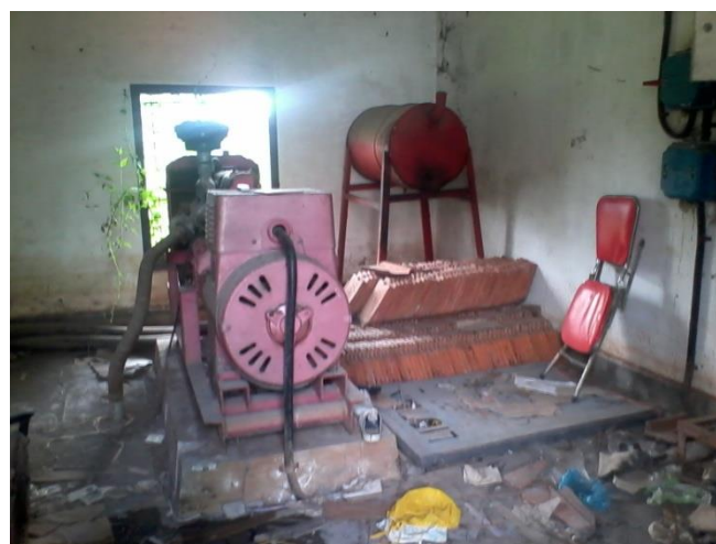
Gbr. 10 Genset dalam Ruang Panel (Rusak)
