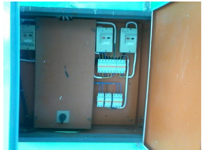
Gbr.20 Dalam Panel PHB Listrik
