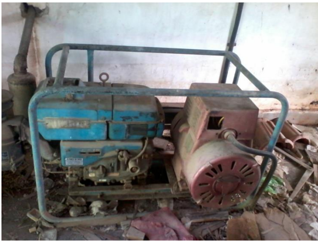
Gbr. 12 Genset yang Mangkrak
