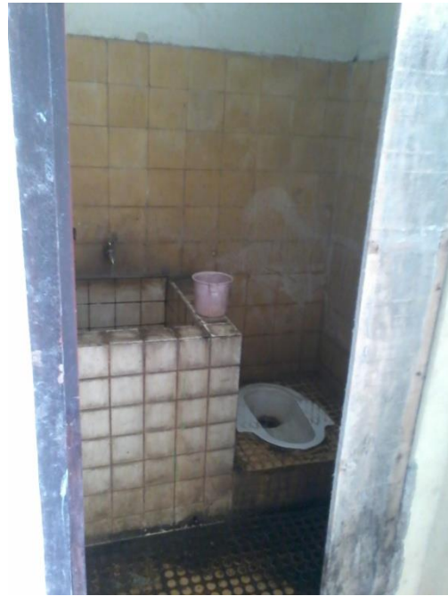
Gbr.14 Toilet Kotor dan Tidak Terawat
