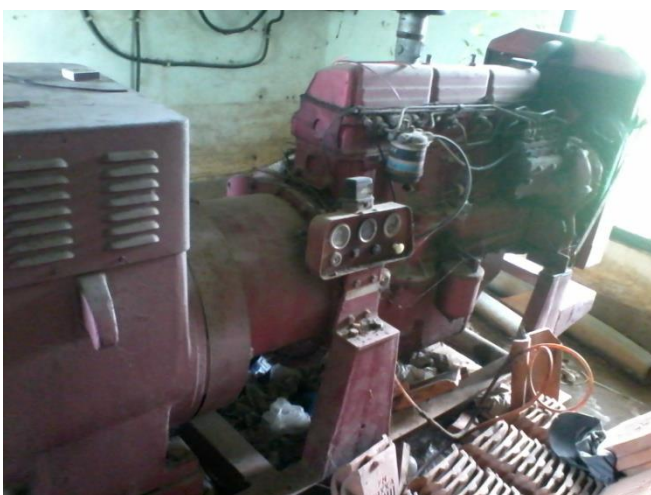
Gbr.13 Genset yang Tak Terawat
