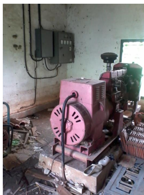
Gbr. 9 Ruang Panel Listrik dari Dalam
