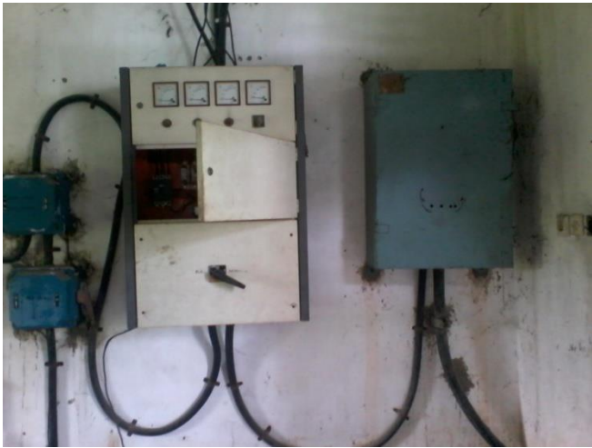
Gbr. 11 Panel Listrik yang tak terawat
