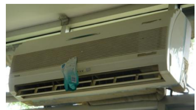
Gambar 4. Evaporator pada unit indoor.
