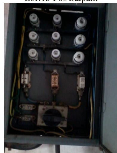
Gbr.16 Kondisi PHB Listrik
