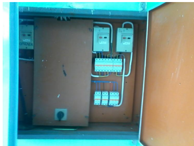
Gbr.20 Dalam Panel PHB Listrik
