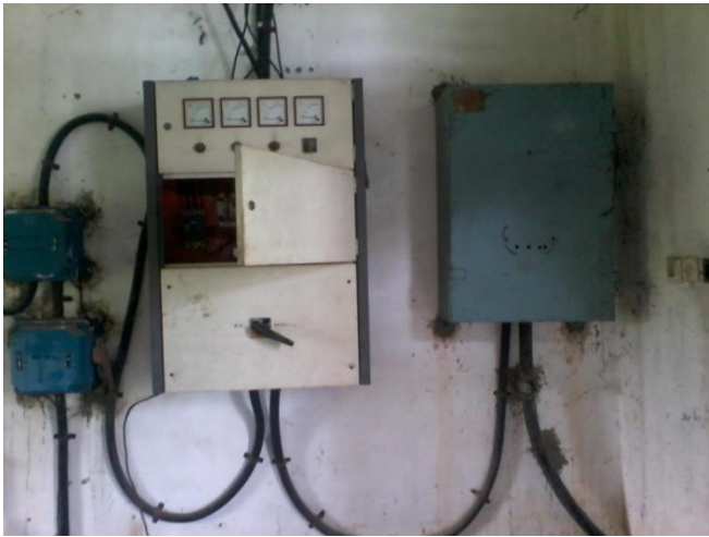
Gbr. 11 Panel Listrik yang tak terawat
