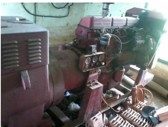
Gbr.13 Genset yang Tak Terawat
