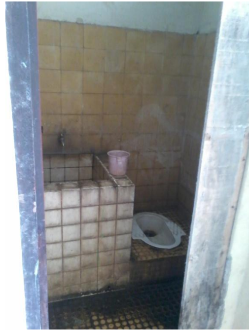
Gbr.14 Toilet Kotor dan Tidak Terawat
