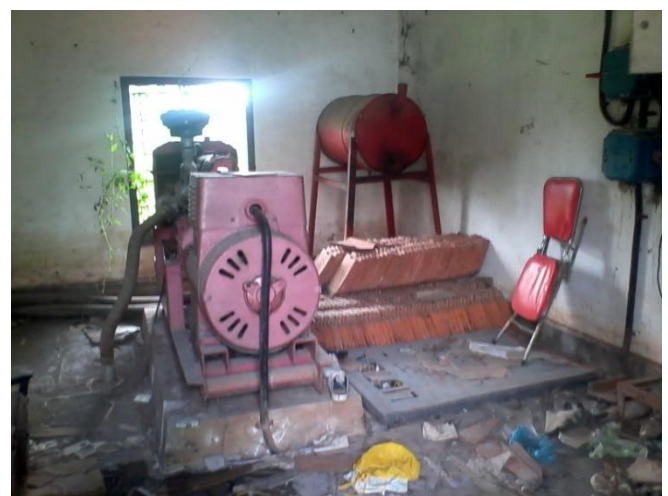
Gbr. 10 Genset dalam Ruang Panel (Rusak)
