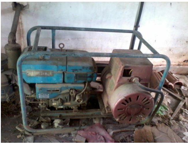
Gbr. 12 Genset yang Mangkrak
